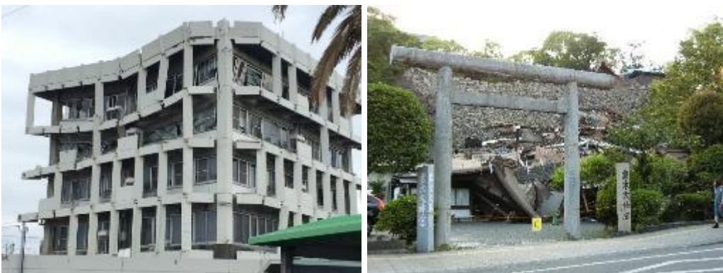
▲地震により倒壊した宇土市役所（左）／倒壊した神社（右）
